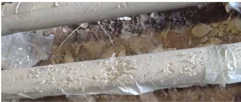
Теплоизоляция на магистралях системы отопления в подвале дома ул. Кирова, 36, превращённая кошками в коготочку. Как будем после этого экономить энергоресурсы, товарищи?
